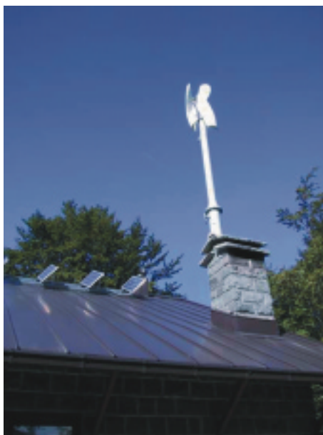
Macchina eolica installata sul tetto
